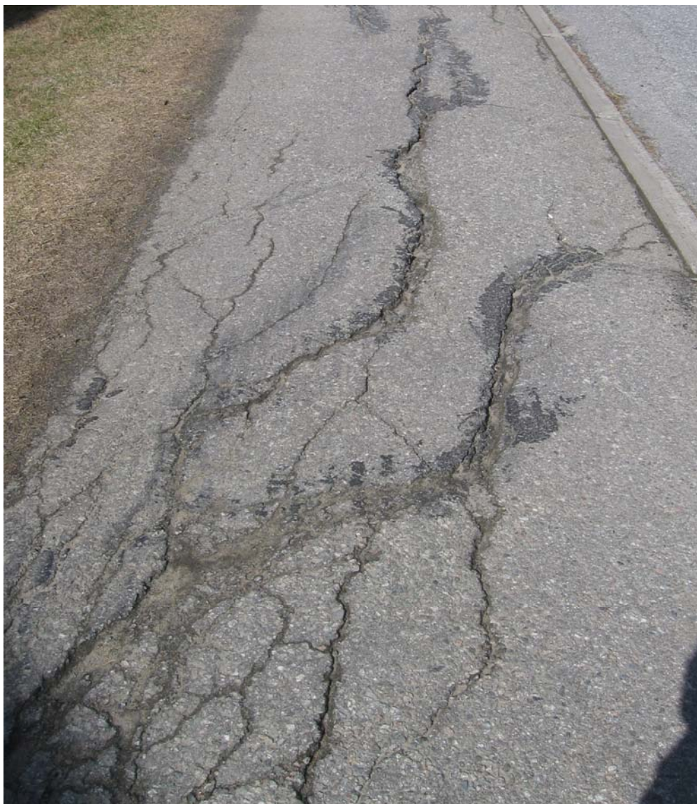
Kuva 29. Kuntalaisten talon kohdan kevyen liikenteen väylällä olevia päällystevaurioita.
